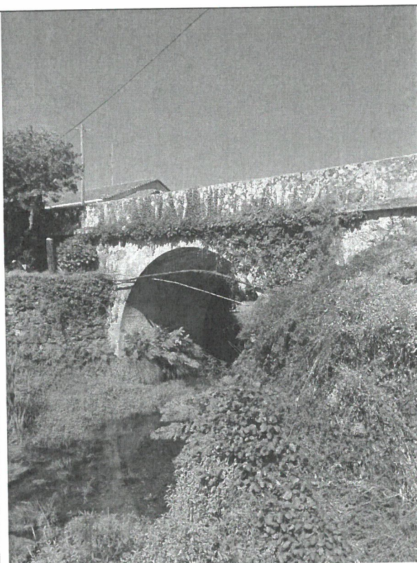
Intensa vegetação a cobrir a ponte (vista a jusante)
