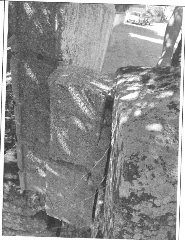
Obstrução da evacuação das águas pluviais
