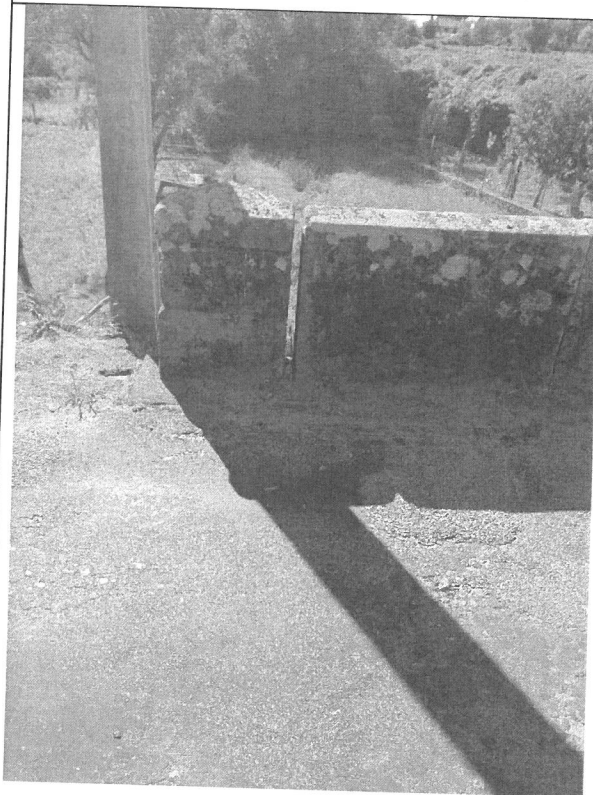
Abertura de junta bastante evidenciada
