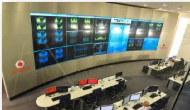
NOC Atlântico (Centro de Controlo de Redes de Comunicações)
